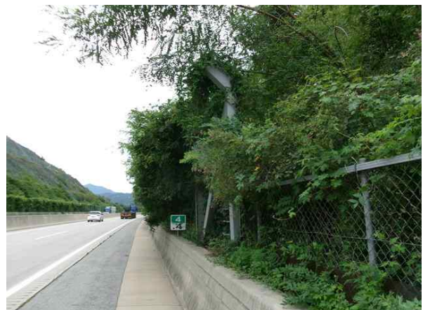
도로부, 낙석방지울타리 전경
