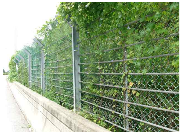
도로부, 낙석방지울타리 전경
