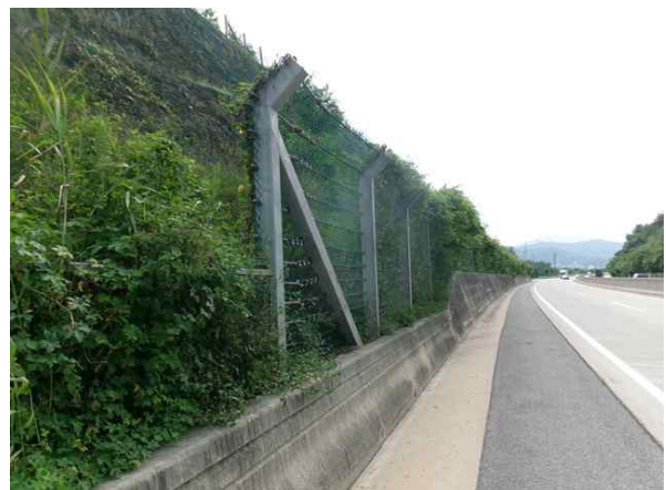
도로부 낙석방지울타리 전경
